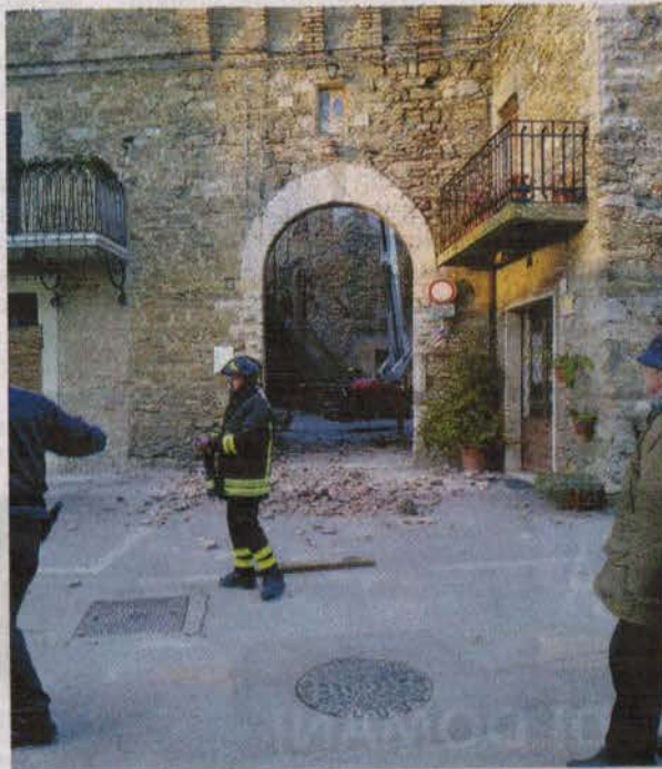
La frazione di Spina è stata una delle più colpite dal terremoto
